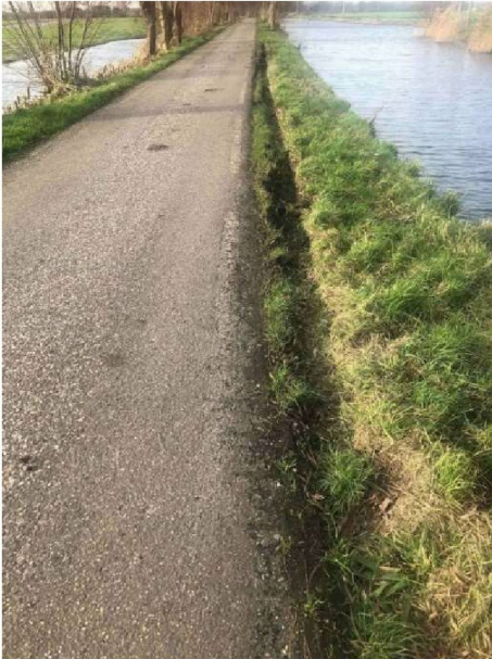
Figuur 2. Schade Gravekoopsedijk
