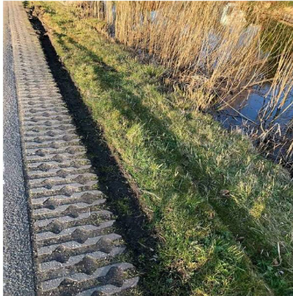
Figuur 3. Schade Zoetendijk
